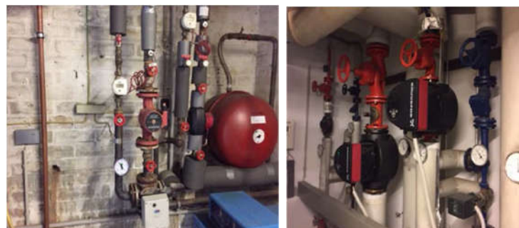
Einbaubeispiele alte und neue Heizungspumpen aus dem Projekt
