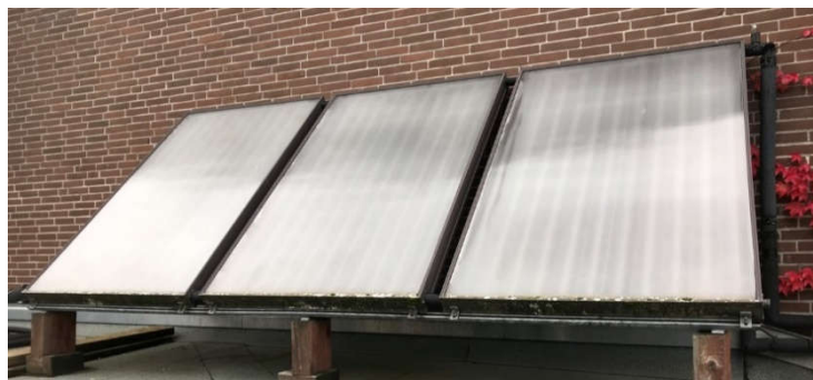
Solarkollektor aufgeständert auf einem Flachdach
